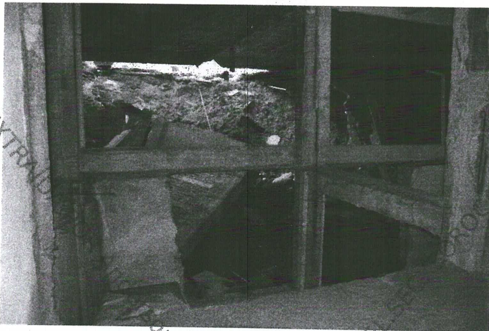
Fotografia 8: Vista a partir da estrutura immobilizada pós-queda, observada a partir de piso interno
