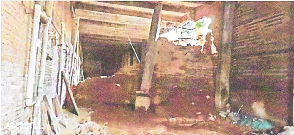
Foto 44: vista da parte direita da cortina, observando-se seu deslocamento por escorregamento sem tombamento, mas "girando no plano horizontal".
