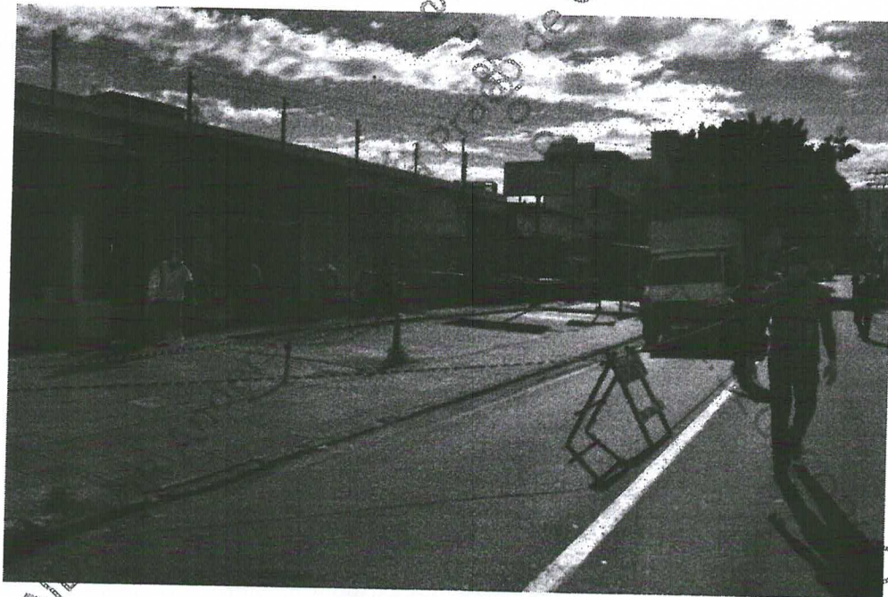
Fotografia 1: Vista geral da rua nas proximidades do desmoronamento
