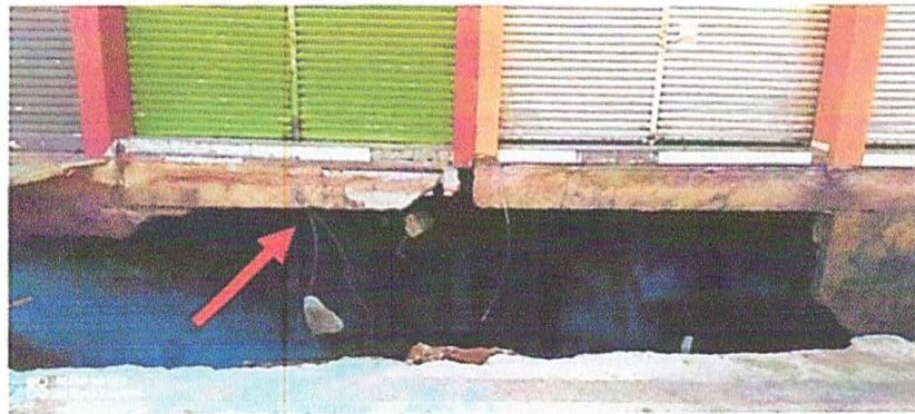
Foto 08: vista da viga citada acima (assinalada), sob a soleira das entradas-portões metálicos de enrolar das lojas.
