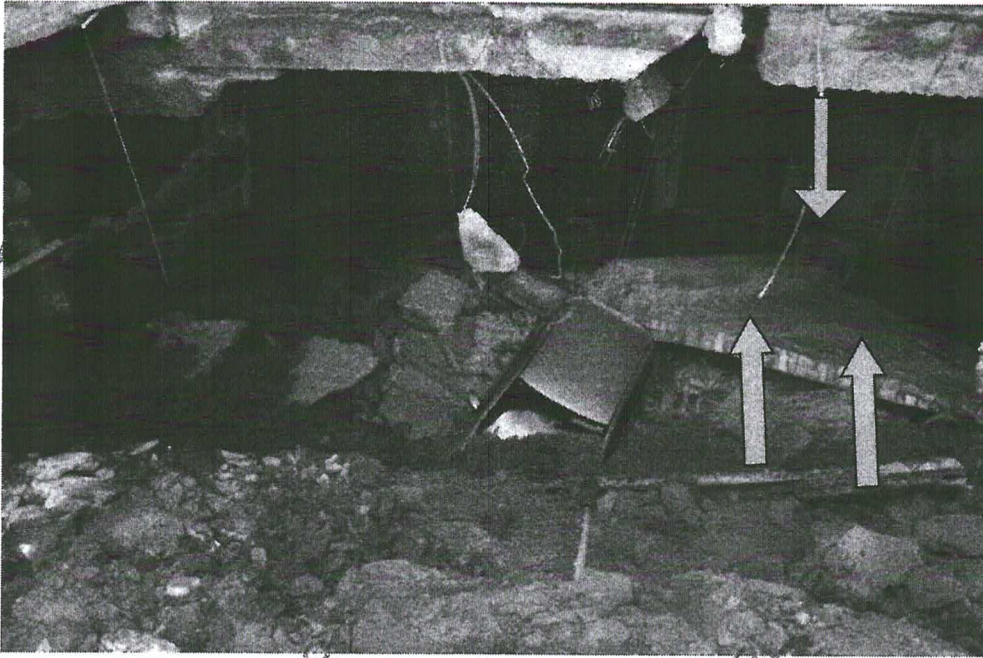
Fotografia 6: Vista superior frontal da situação final, onde estão indicadas por setas partes da estrutura de arrimo podendo-se observar posicionamento de bloco de fundação deslocado da frente para trás caracterizando resistência lateral insuficiente resultante das escavações internas.
