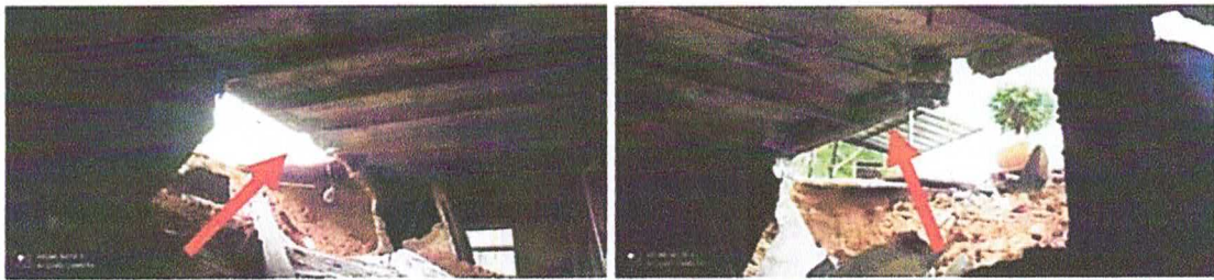
Fotos 09 e 10: destinadas a ilustrar o sistema estrutural na região do desabamento e assinalada a viga citada.
