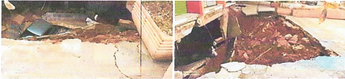
Fotos 06 e 07: vista da ruptura do pavimento de concreto simples do estacionamento, região assinalada na foto 05.
