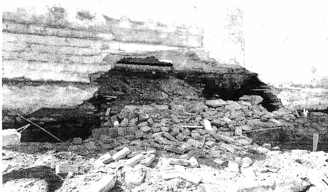
Foto 04) Local onde houve o deslizamento provocando a queda parcial da parede.
