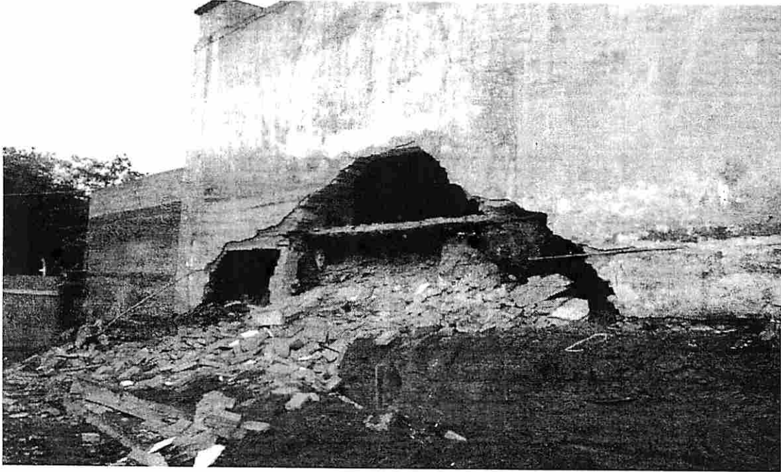
Foto 07) Queda da parede abaixo do banheiro e do quarto.
