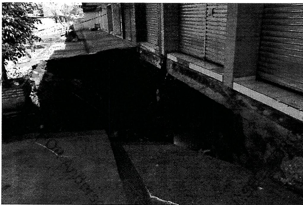
Fotografia 4: Vista oposta parcial do resultado do desmoronamento
