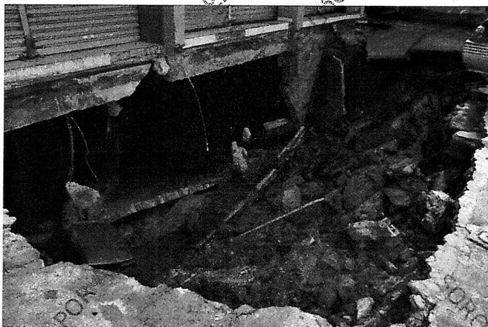
Fotografia 3: Vista parcial do resultado do desmoronamento onde à esquerda da fotografia observa-se o veículo que se encontrava sobre o ponto do calçamento.
