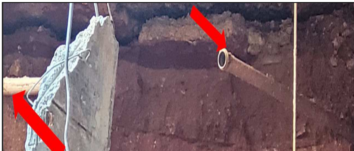
Detalhe da falha. Canos de rede.
