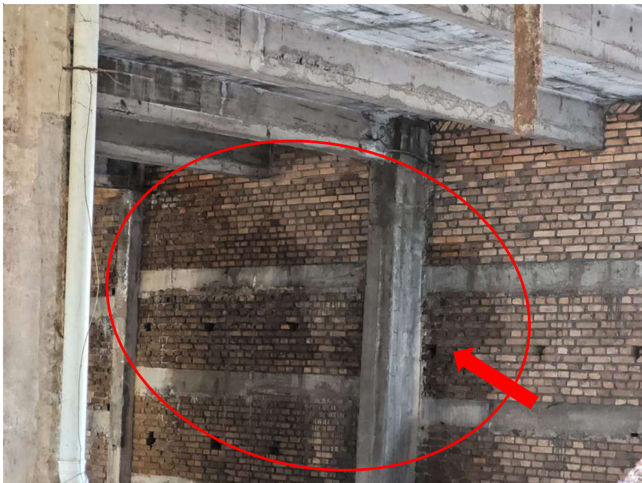
Foto 5- Detalhe de onde está também com ponto de infiltração da tubulação da rede de água..
