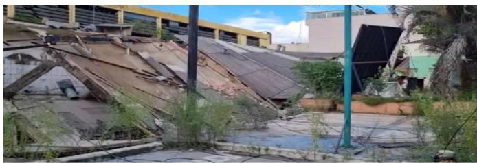
Avenida é interditada em São Roque após desabamento de imóvel — Foto: São Roque Notícias/Reprodução
